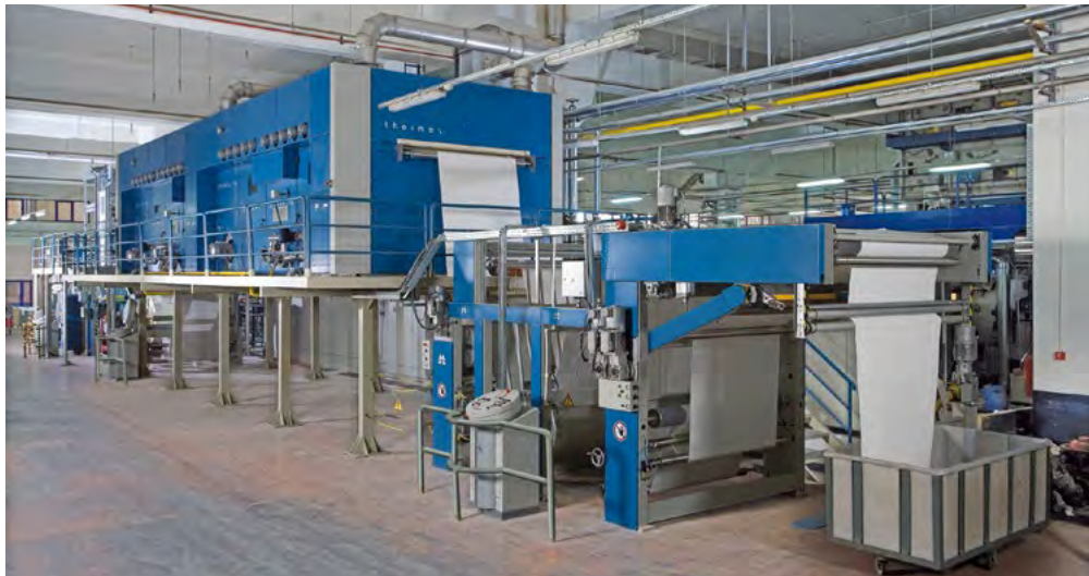
Eine aktuelle Thermex-Installation in Italien © 2023 Monforts
