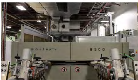
Das kanadische Unternehmen Albarrie profitiert nun von einer der ersten Monforts Montex-Spannmaschineninstallationen, die mit der gesamten Palette der MonforClean-Wärmerückgewinnungs- und Abluftreinigungstechnologien ausgestattet ist © 2023 Monforts
